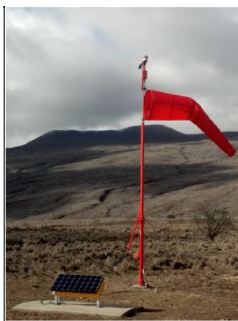
Figura 38 - Modelo de biruta iluminada fotovoltaica
