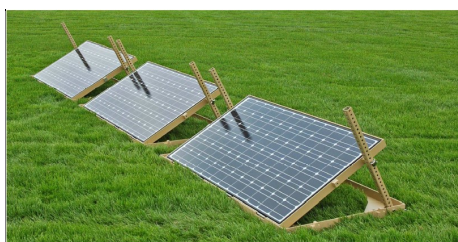
Figura 35 - Painéis fotovoltaicos do PAPI
