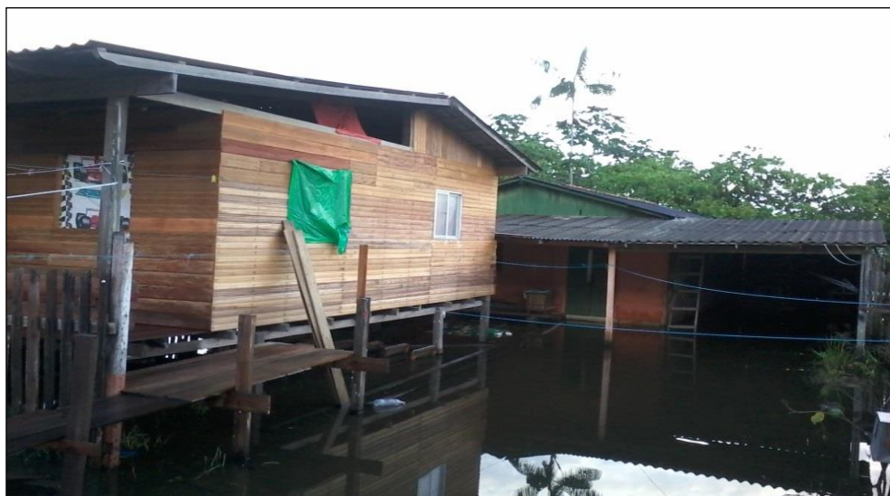
Figura 07: Pequeno cômodo adaptado no período da cheia estrutura externa. Foto: Gerson Mesquita, 2015.
