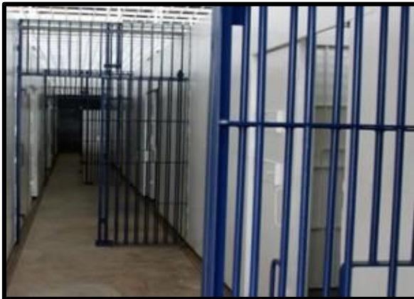
Figura 2: Cella de Segurança da Sala de Aula na Unidade Prisional de Tabatinga/AM.
