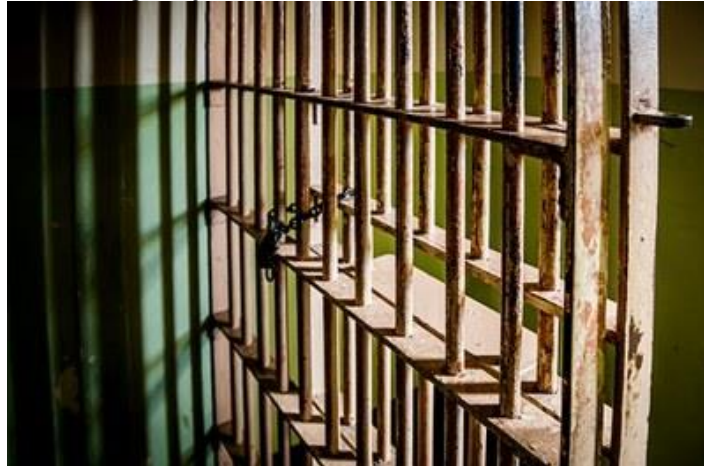
Figura 7: Cella de Segurança da Sala de Aula na Unidade Prisional de Tabatinga/AM
