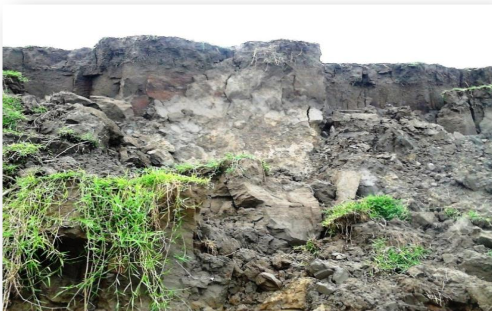
Figura 03: O perigo das terras caídas na localidade. Fonte: Emanuel Tavares
