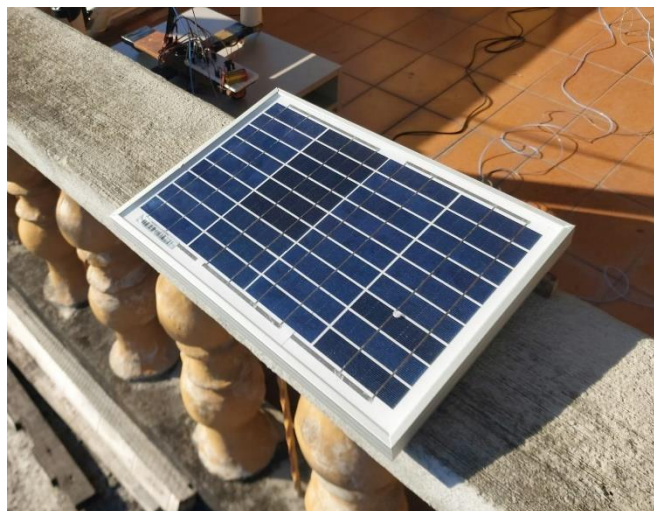
Figura 49: Sistema fixo de coleta de energia solar
