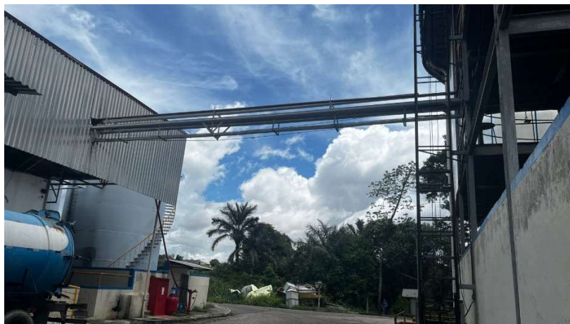
Figura 35 – Maquinário do processo industrial (tubulação)
