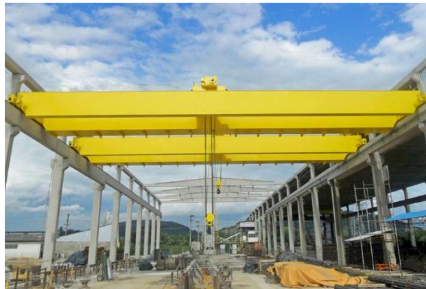
Figura 1 - Ponte rolantes para movimentação de grandes cargas
