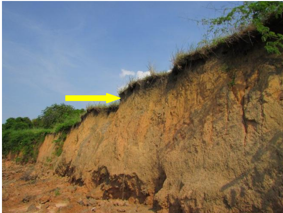
Imagem (38): Erosão fluvial – faixa de TPI em destaque.
