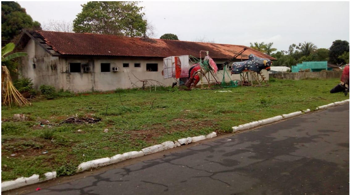
Imagem 4: Obra de Hospital abandonada. Fonte: Joelder Ribeiro, 2019.
