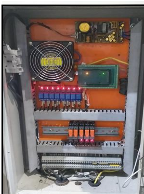
Figura 26 – Disposição interna dos módulos no painel
