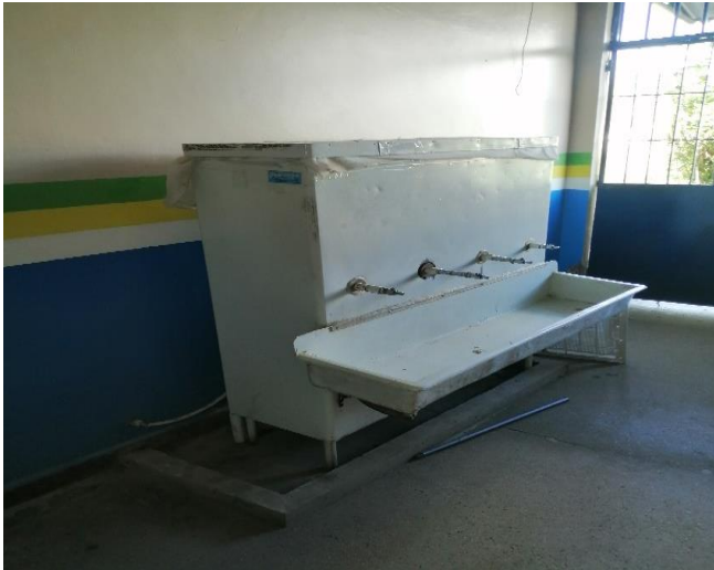
Figura 18- Local de armazenamento da água
