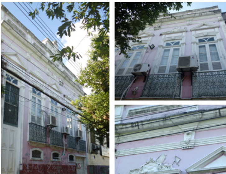
Figura 3. Fachada da segunda sede, rua Simão Bolívar; 2. Aspecto geral das esquadrias na fachada; 3. Topo das esquadrias. Fotografias da autora.
