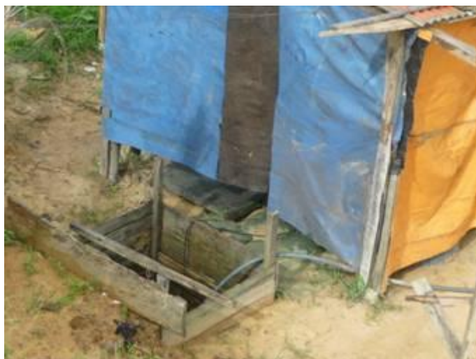
Figura 4: Banheiro de chão ao lado de uma cacimba, ambos em cima da nascente.
