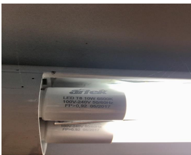
Figura 12 - Especificações de Lâmpada LED Tubular
