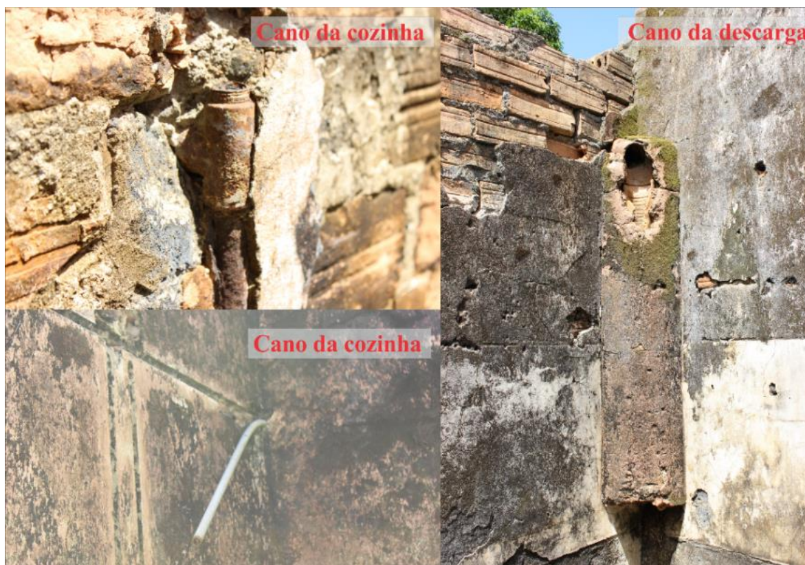
Figura 20 – Cano de ferro da cozinha da casa em ruínas do Fomento
