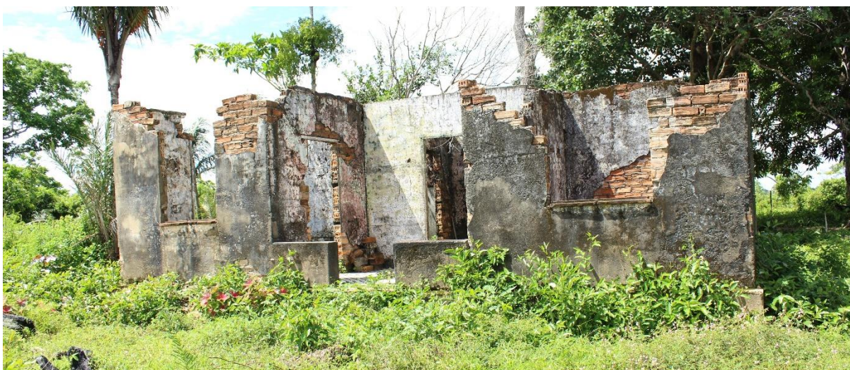
Figura 17: Casa em ruínas no Fomento
