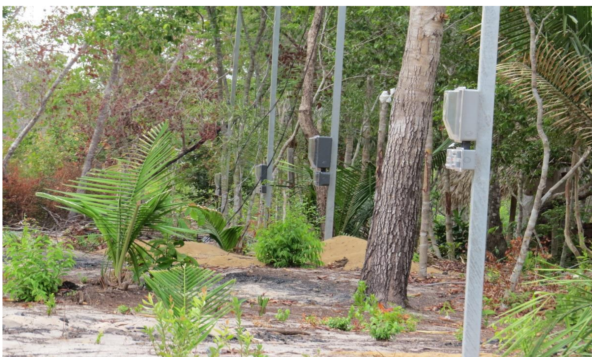
Figura 5 – postes de energia elétrica instalados na Área Indígena
