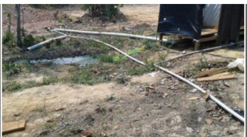
Efluentes lançados diretamente no solo
