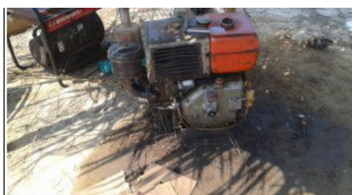
Gerador com óleo vazando para o solo
