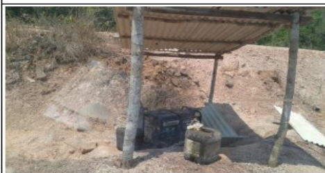
Pequeno gerador e vasilhame de combustível
