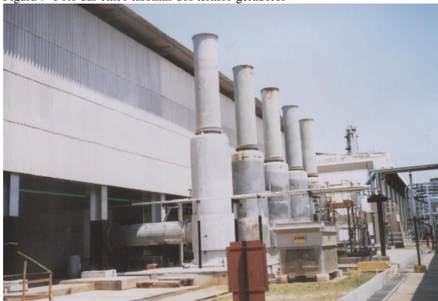
Figura 7 -Foto das cinco turbinas dos termos-geradores
