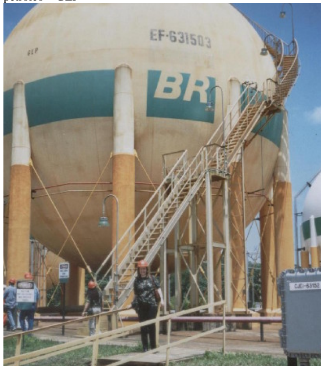
Figura 5– Foto de esfera de armazenamento de gás liquefeito de petróleo – GLP
