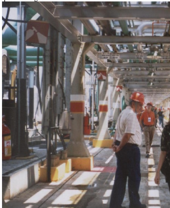
Figura 6– Foto de parte da tubulação de passagem de petróleo e gás
