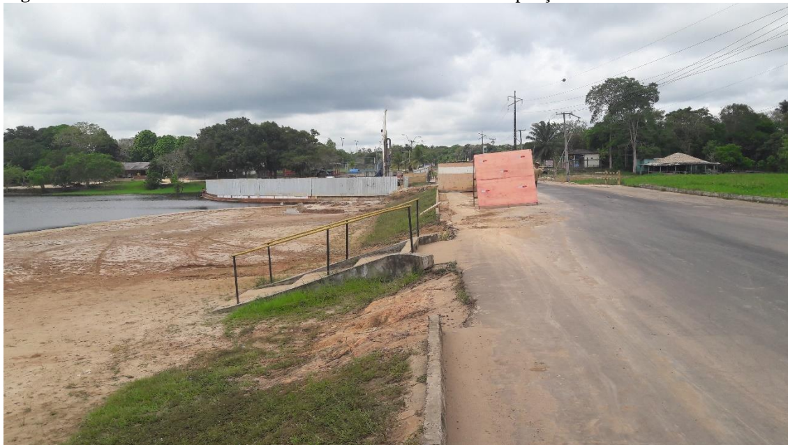
Figura 4-8: Trecho onde está localizado o balneário em obras de ampliação da rodovia.
