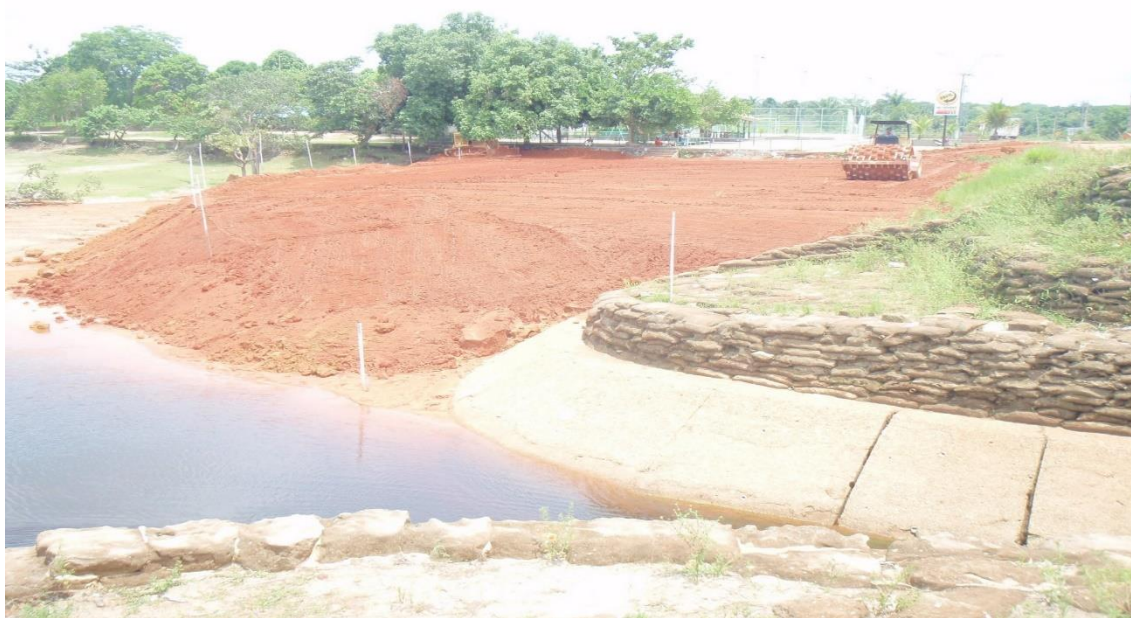
Figura 3-3: Obra realizada pela prefeitura municipal durante construção da orla do balneário do Miriti.
