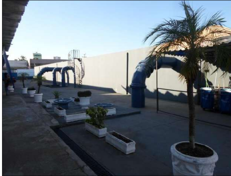
Figura 16: Reservatório apoiado do CR1
