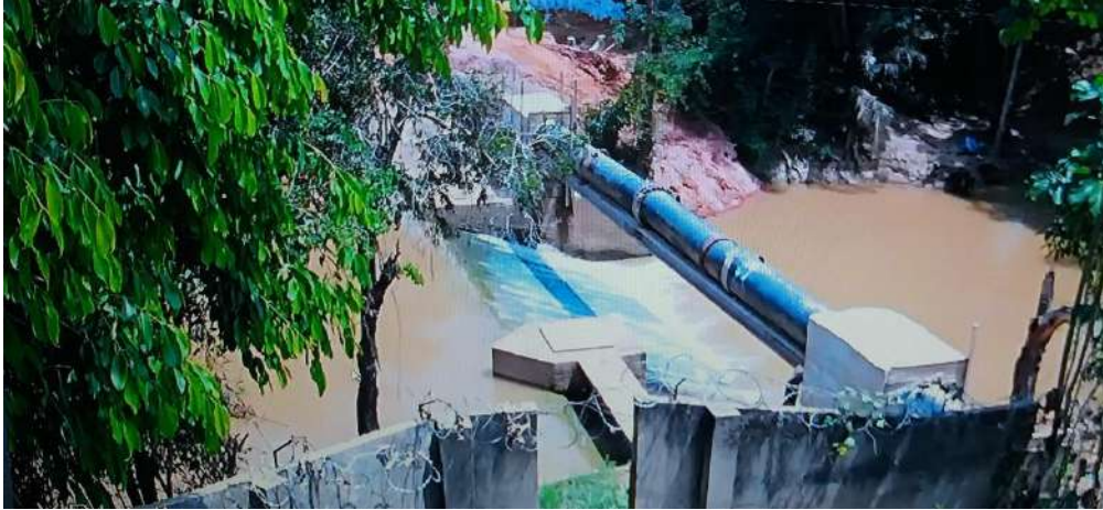
Figura 34: Travessia da adutora de água bruta sobre igarapé Bate-Estaca
