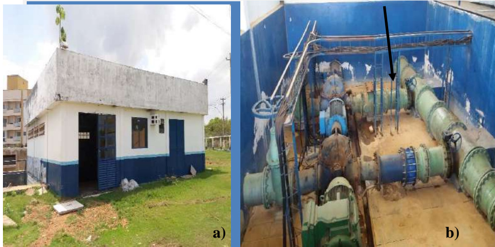
Figura 29: Estação elevatória de água tratada – ETA nova
