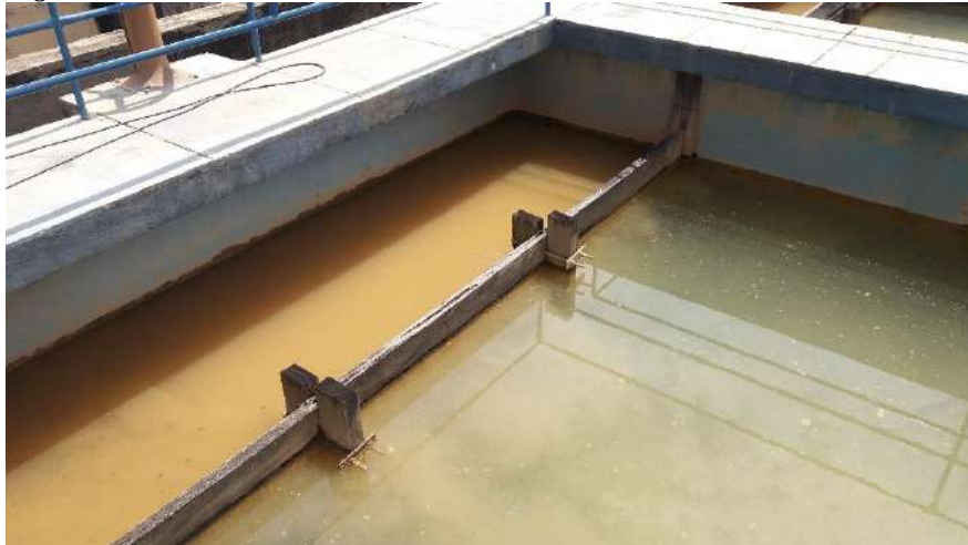
Figura 26: Entrada do decantador
