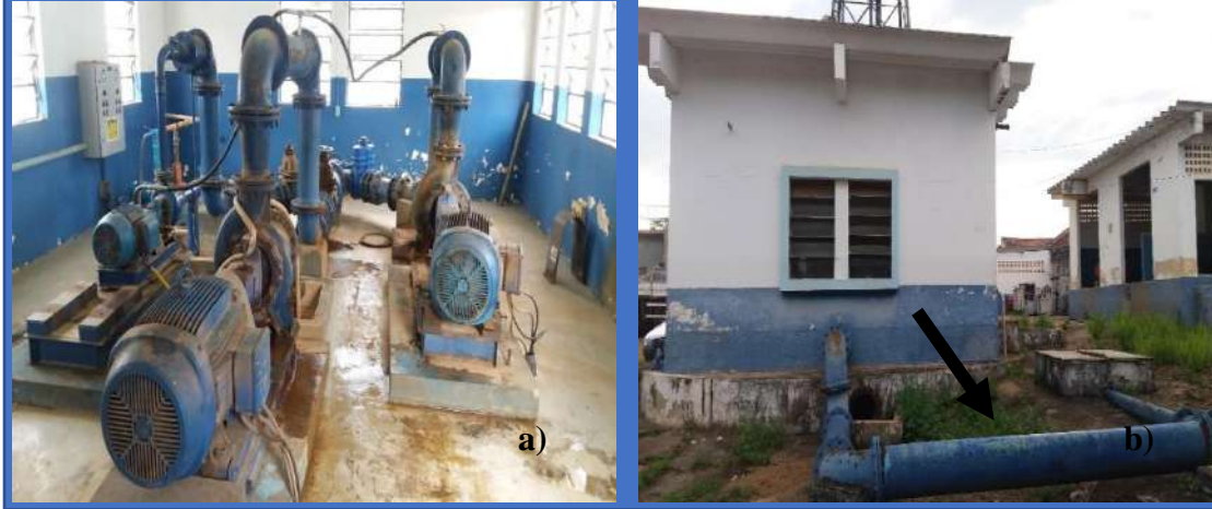
Figura 31: Estação elevatória de água tratada – ETA velha
