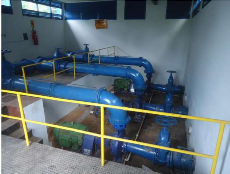
Figura 2: Estação Elevatória de Água – EEA de Ji-Paraná
