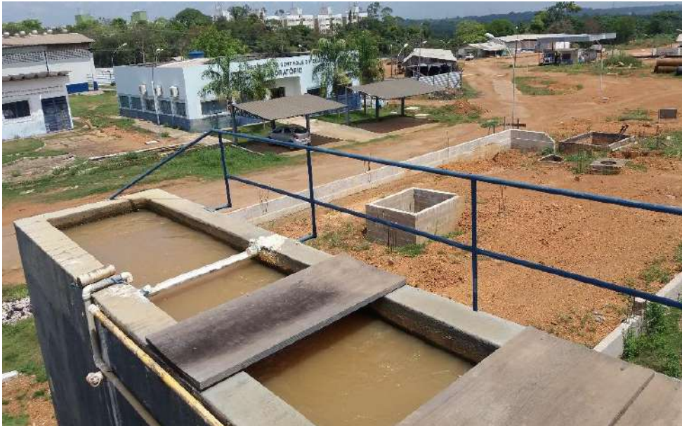
Figura 24: Calha parshall da ETA nova.
