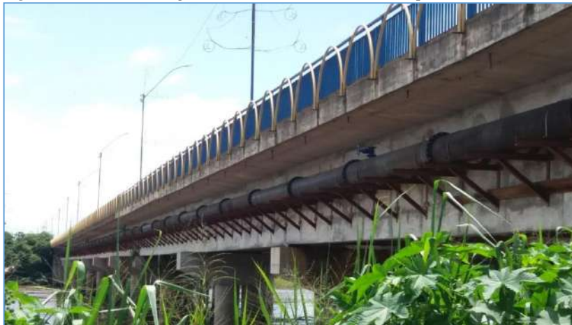
Figura 3: Adutora de água tratada, DN 500 mm, sob a ponte do Rio Machado
