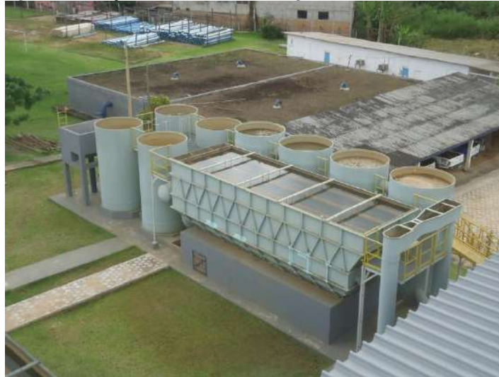
Figura 4: Estação de Tratamento de Água de Jaru
