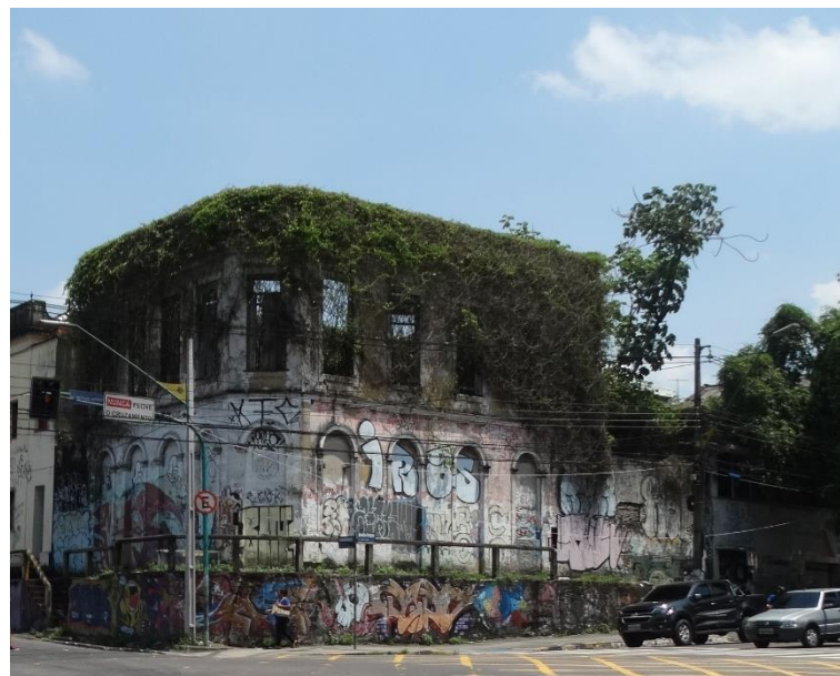
Figura 1- Casarão abandonado na Avenida Leonardo Malcher esquina com a Getúlio Vargas. Fonte: William Rodrigues, 2017.
