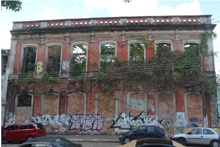
Figura 2 - Ruínas do Hotel Cassina. Fonte: William Rodrigues, 2017.
