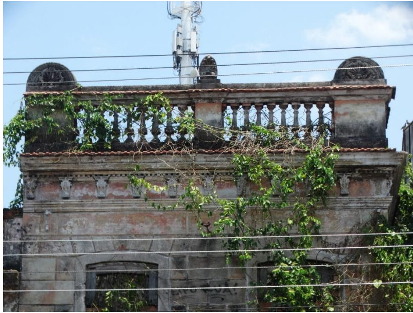
Detalhes da edificação que foi casa do Inspetor da Alfandega, Mario Gomes. Fonte: Autor, 2017.
